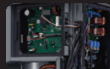
Gasdichte regelkast (binnenkant)
